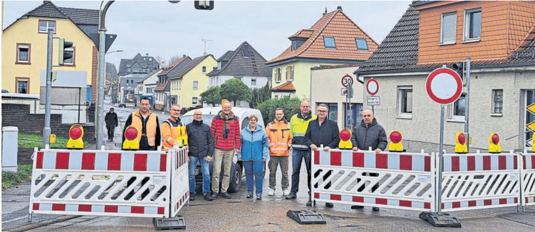
Die Bahnhofstraße als Ortsdurchfahrt von Flensungen ist nun wieder frei, die Bauarbeiten wurden schneller als geplant abgeschlossen.
