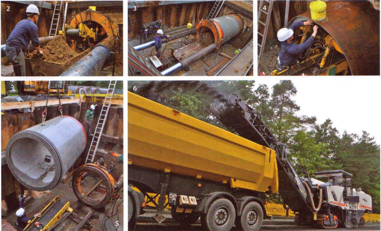
Abb. 2 Das an der Ortsbrust abgebaute Erdreich wurde per Fließband kontinuierlich nach hinten gefördert. Abb. 3 Das in Gießen eingesetzte Schildvortriebsaggregat der Herrenknecht AG kann bis zu 616 Tonnen pressen. Abb. 4 Einlegen eines Dichtungsringes vor Positionierung eines neuen Rohrs. Abb. 5 Sieben Tonnen im Schwebezustand: Einbau von einem der sechs Stahlbetonrohre, die unter der Vogelsberg-Bahn hindurchgepresst wurden. Abb. 6 „High Tech“ auch oberirdisch: Dieser Prototyp einer Asphaltfräse von Wirtgen, auf der Licher Straße im Testeinsatz, fräst ganze Fahrbahnen von 2,10 Meter Breite auf einmal ab.
