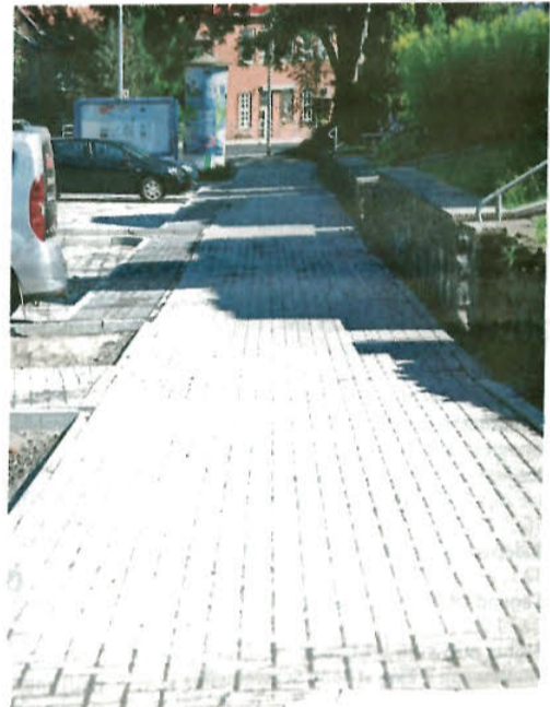
Pflaster oder Asphalt? Wegen der Erneuerung der Gehwege hatte es Unstimmigkeiten gegeben.
