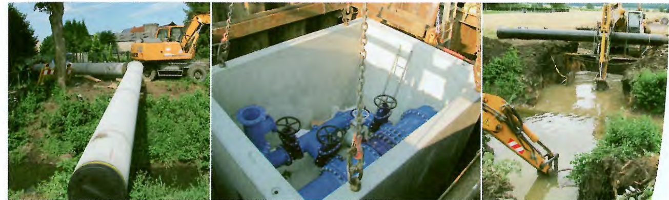
Das Rohr wartet darauf, unter der Horloff verlegt zu werden, durch die ein Graben gebaggert wurde. Daneben sitzt der Entleerungsschacht (Mitte).
